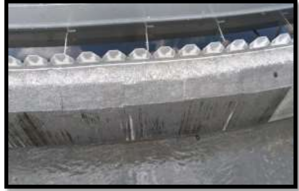
Çökeltme Havuzu Çıkış Suyu
