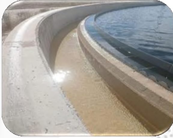
Çökeltme Havuzu Çıkış Suyu
